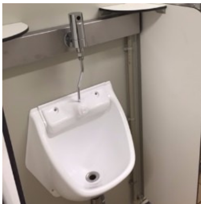
Installazione degli orinatori elettronici IDRAL nei bagni EXPO 2015
